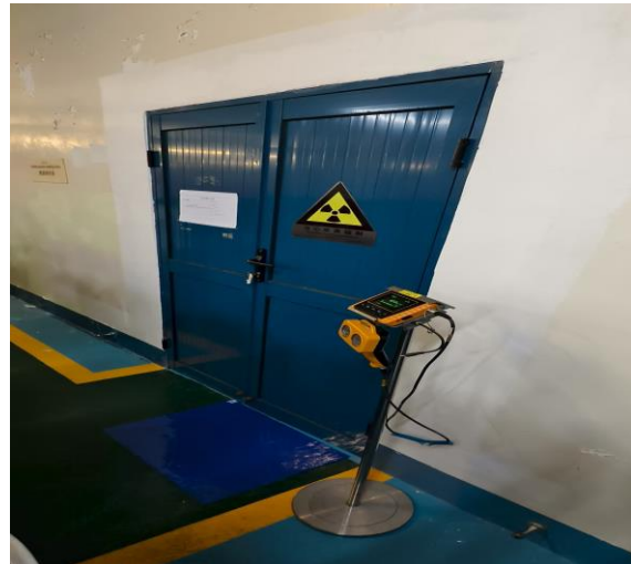
图 3-2.2 碘源操作间外门口（缓冲区）
