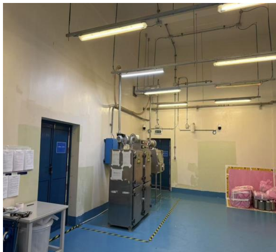
图 3-2.1 碘源操作间内（控制区）
