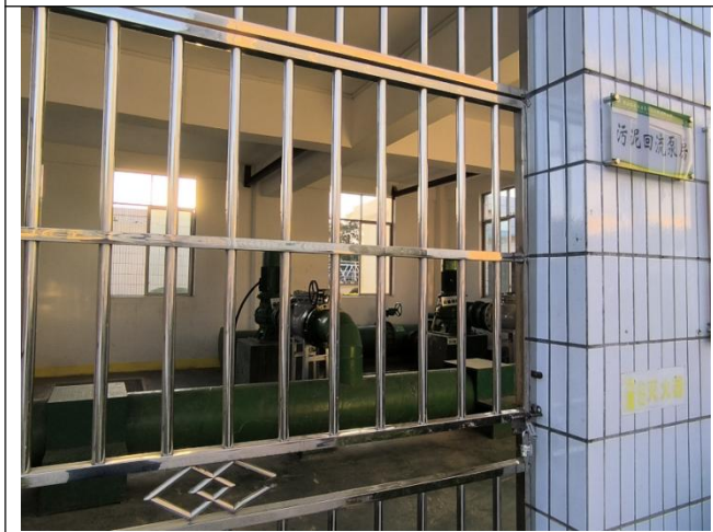
污泥回流泵房
