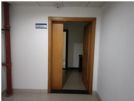
图 3-7 危废间进入门视频监控
