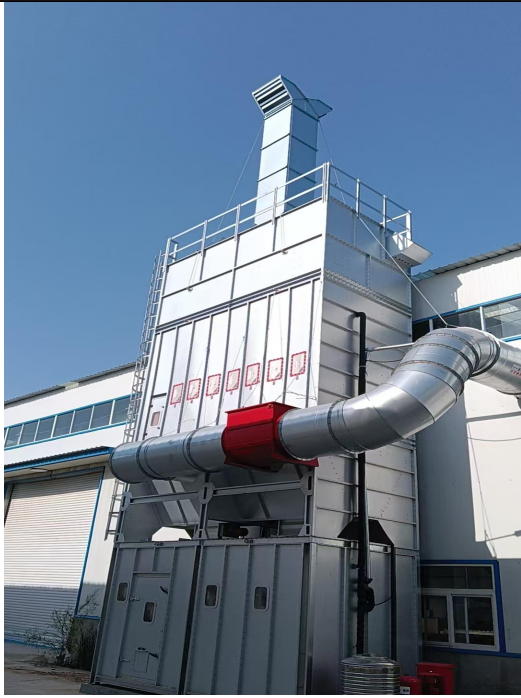
图6 环保设施（袋式除尘器）
