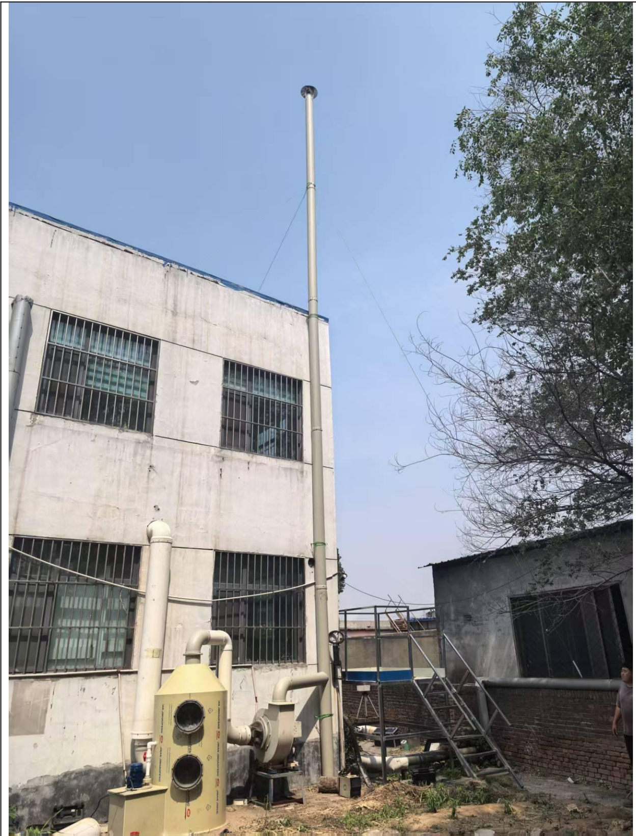
图3 环保设施（碱液喷淋）及有组织排气筒DA001
