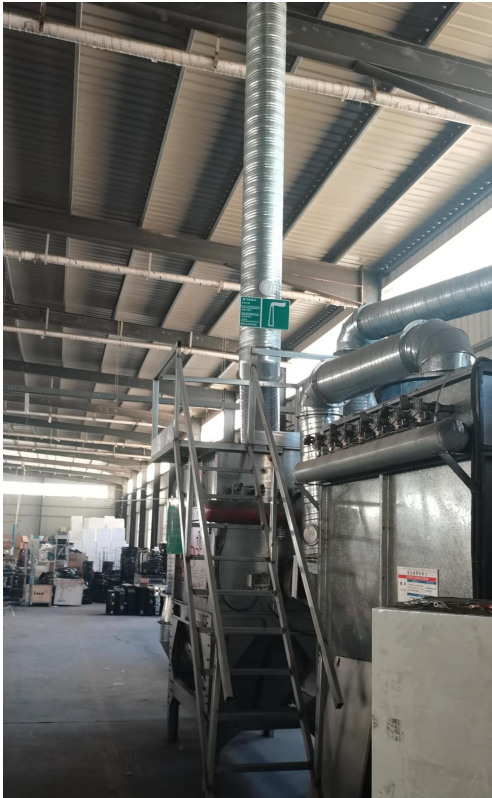
图3 喷粉工序废气排气筒DA001
