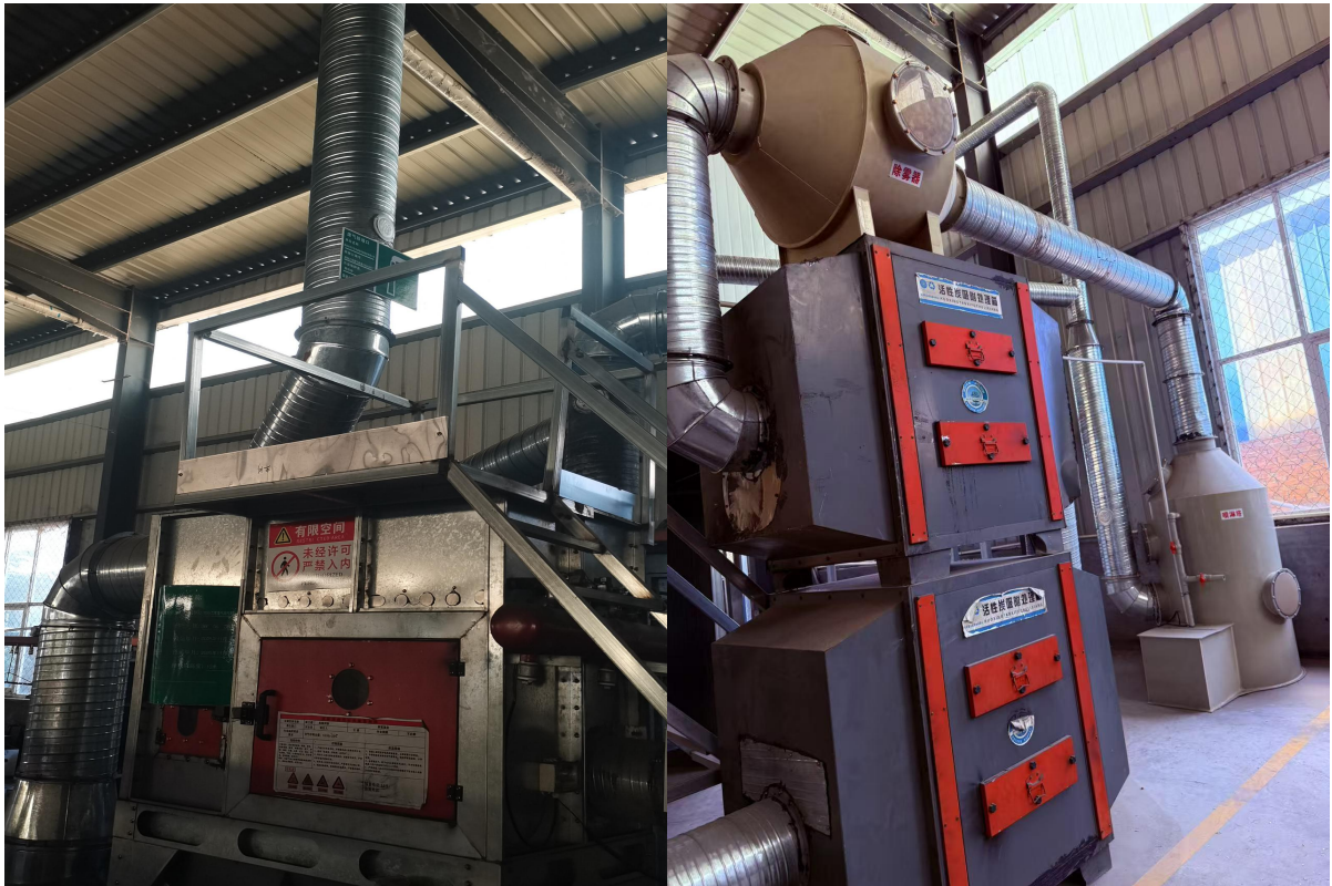
图6 DA001环保设施 (旋风+布袋除尘器)
