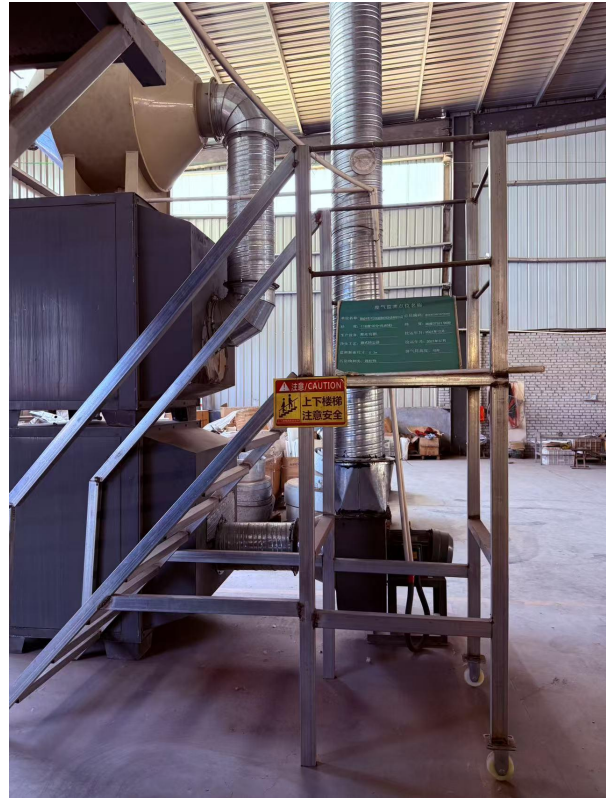
图4 固化工序废气排气筒DA002
