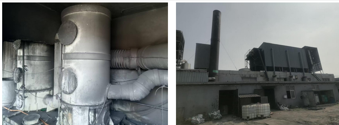
图 4-1 废气处理设施图片
