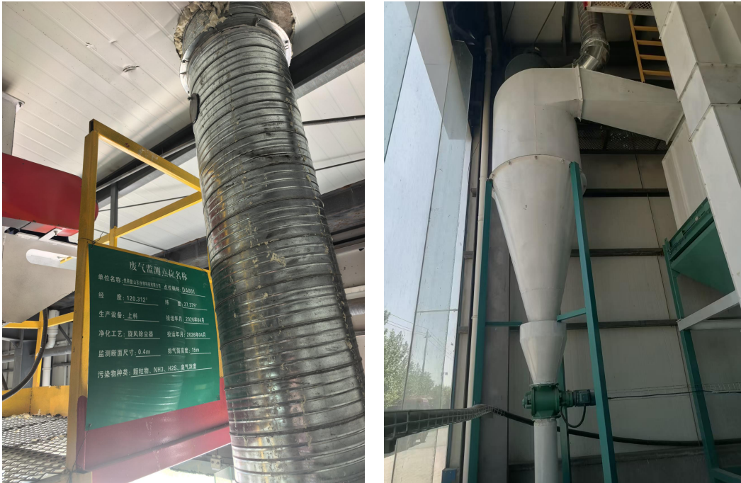
图 4-1 废气处理设施图片
